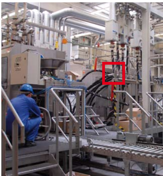
Abfüllanlage im Innenbereich: Das RS-Schlauchdrehlager schützt vor Torsion, die RS-Schaleneinbindung sichert die Schlauchverbindung.
